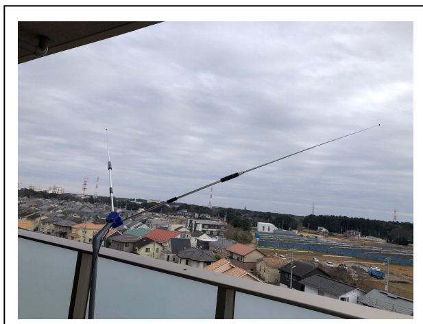
ベランダでの設置事例（VP 管 45 度エルボ使用）
